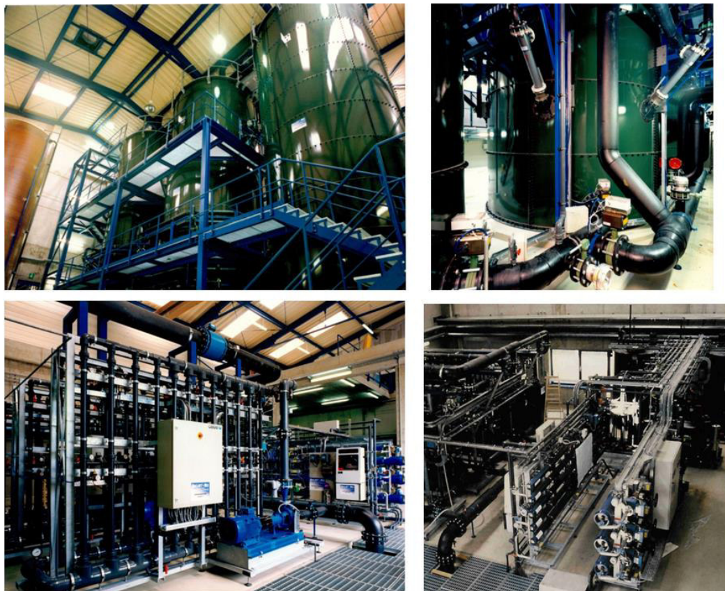
Abbildung 1: Großanlage zur Deponiesickerwasseraufbereitung
