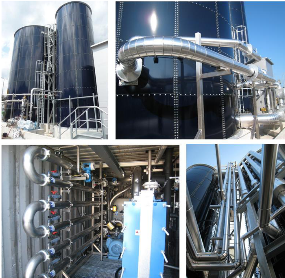
Abbildung 2: Großanlage Abwasseraufbereitung der Biodieselerzeugung
