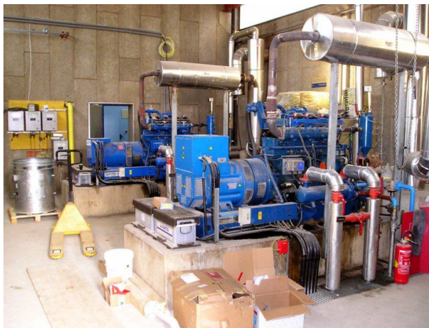
Abbildung 5: Vorhandene Blockheizkraftwerke auf der Abwassertreinigungsanlage des AWV Knittelfeld (Gasmotorenhalle)
