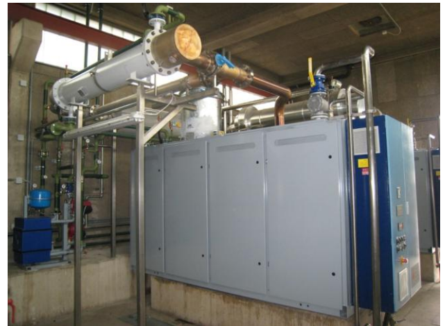
Abbildung 6: Neue BHKWs mit insgesamt 330 kW el
