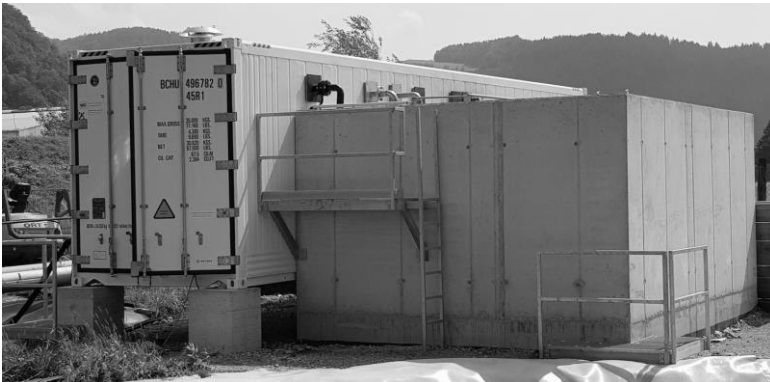
Abb. 1: Betriebscontainer und Biologiebecken.
