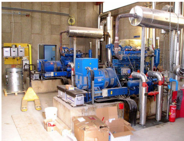
Abbildung 6: Vorhandene Blockheizkraftwerke auf der Abwassertreinigungsanlage des AWV Knittelfeld (Gasmotorenhalle)
