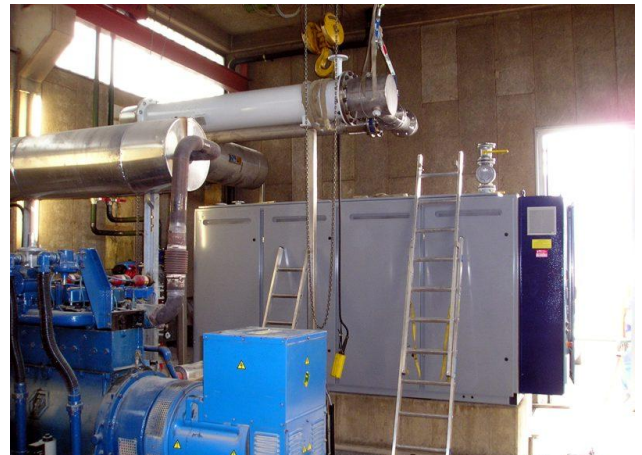
Abbildung 7: Vorhandenes Blockheizkraftwerk Köhler&Ziegler der Abwasserreinigungsanlage AWV-Knittelfeld (Gasmotorenhalle)
